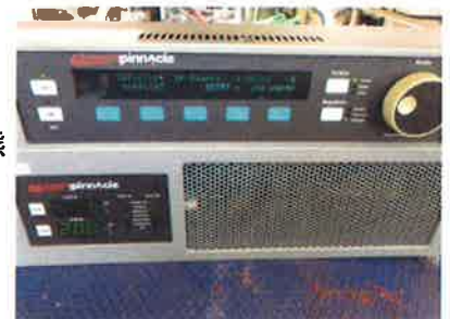
UNIT B HV出力状態
