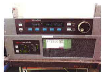
UNIT B 539V,11.31A, 6.097KW 出力状況
