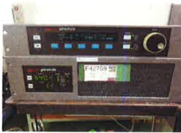
UNIT A 540V,11.24A, 6.072KW 出力状況
