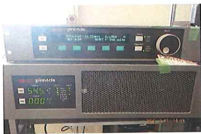
UNIT A 545V,11.22A, 6.115KW 出力状況
