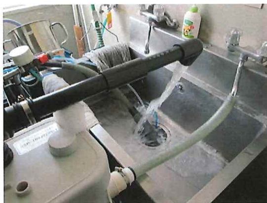
排水動作(状態)・・・排水タンクに強制注水にて作動状態確認
