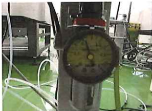
除振台Air供給ポート確認
