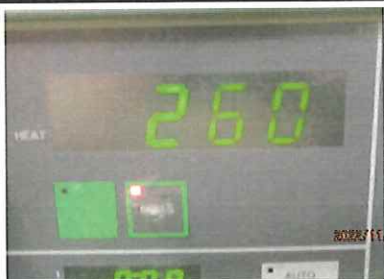
260°Cでの運転状況
