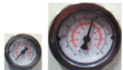
③ポンプ水圧計 OFF時とON時(強制閉路)
