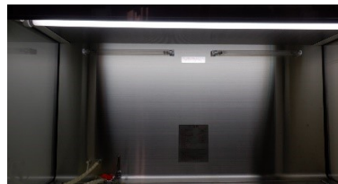
蛍光灯照明点灯
