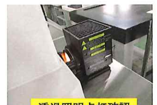
透過照明点灯確認
