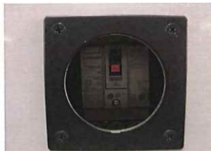
ノーヒューズブレーカ破損の為 ELB直接操作
