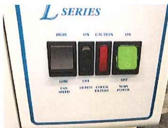
風速常にHIGH、フィルターチェッカー動作しない設定
