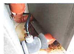
装置内部に錆あり
