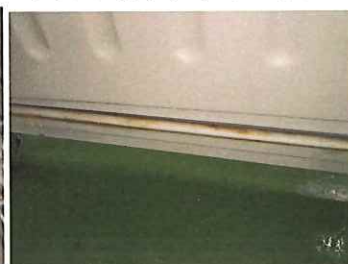
パッキンに汚れ(これ以上取れない)
