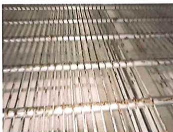
内部ラジエーターに錆
