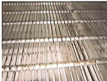
内部ラジエーターに錆
