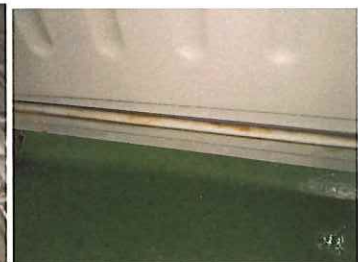
パッキンに汚れ(これ以上取れない)
