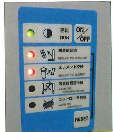
吸着剤交換、エレメント交換のランプ点灯
