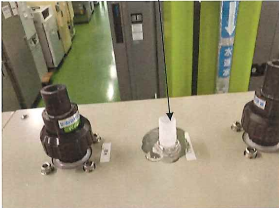
EX-21PV20-DFスクラバーアルカリ供給、薬液ポンプ
