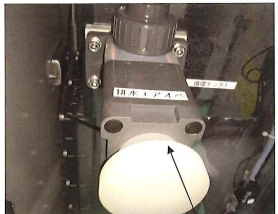
エア導入、で排水用流量調整弁調整
