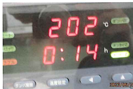
タイマー運転(残り14分の状態)
