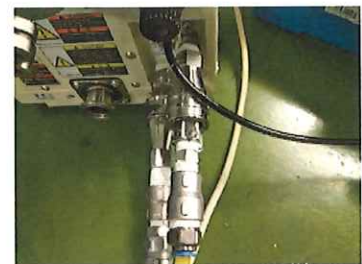
水導入配管、接続プラグ無し。
