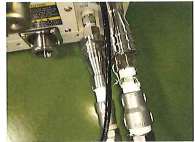
水導入配管接続プラグ無し。
