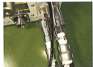
水導入配管、接続プラグ無し。
