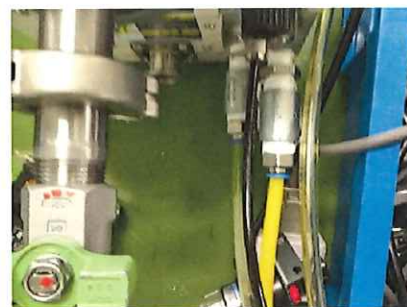
水導入配管、接続プラグ無し。
