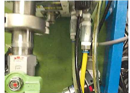
水導入配管、接続プラグ無し。
