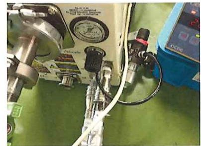
水導入配管、接続プラグ無し。
