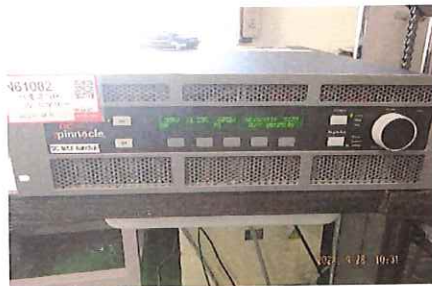
UNIT A 出力状態
