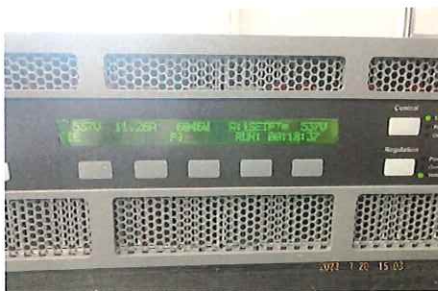
UNIT A 出力状態
