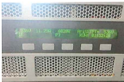
UNIT A 出力状態
