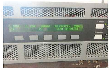
UNIT B 出力状態
