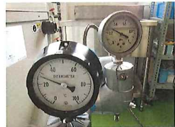
引き上げ先給水温度、圧力計付
