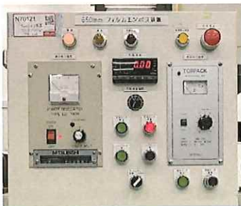
写真② 操作パネル
