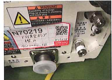
水導入配管、接続プラグ無し。
