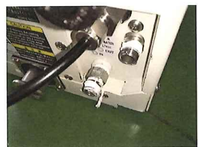
水導入配管、接続プラグ無し。
