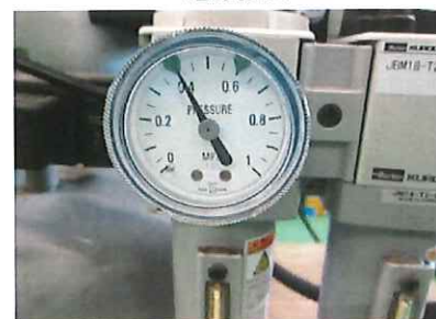
二次側圧力:0.4MPaで負荷へ供給
