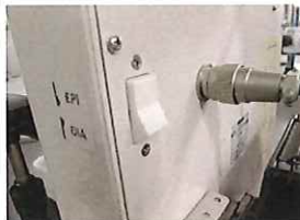
落射照明→点灯せず
