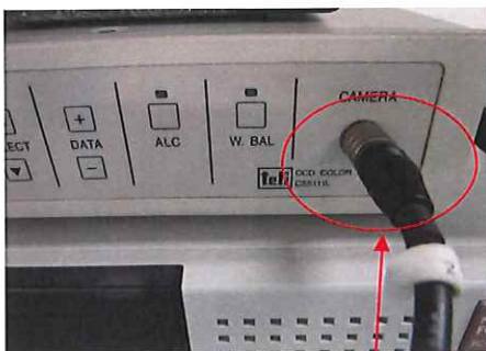
CAMERA CABLE 交換
