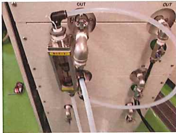
IN,OUT流量計付けて連結
