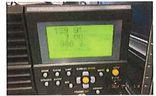
DC電源使用
