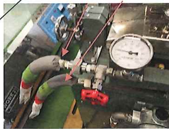
水冷配管IN,OUT
