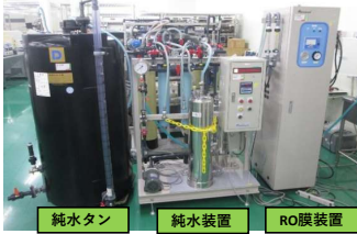
純水タンク 純水装置 RO膜装置
