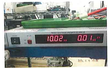
電圧出力 10KV
