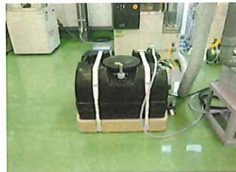
排水貯水タンク
