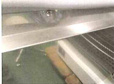
扉内側変形有。
