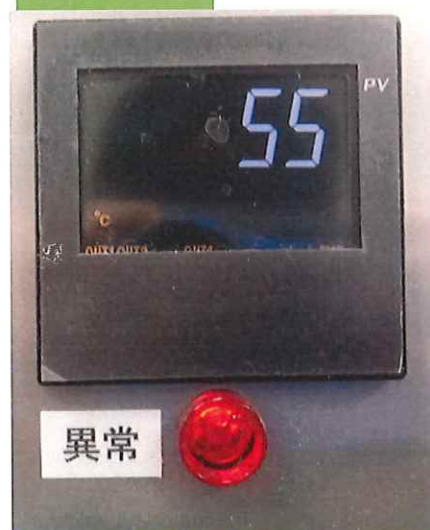
55°Cでブザー、異常ランプ点灯 純水製造装置停止
