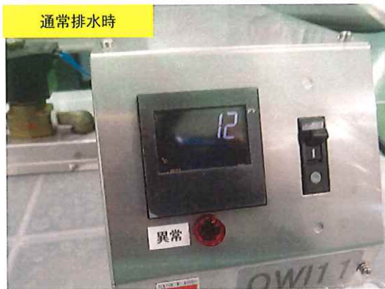
一定間隔で実行のボイラ排水時
