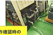
動作確認時の 圧送配管
