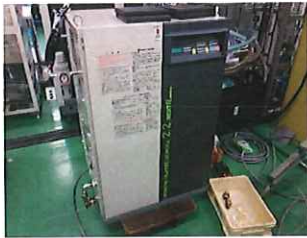
コンプレッサー本体
