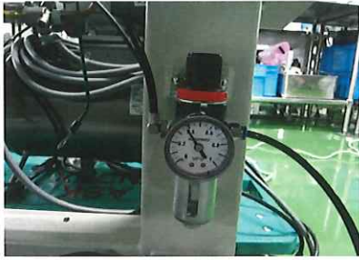
Air供給/防振台フロート確認
