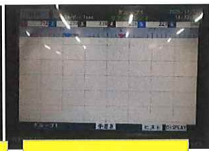
記録計表示 切替確認
