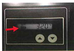
過昇防止装置確認 (異常発生時は矢印部点灯)
