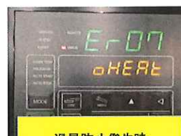
過昇防止発生時 アラーム
