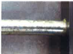
シャフト部の錆
